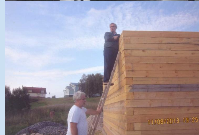
академик РАН Н.П. Лавёров (на лестнице) и д.ф.-м.н. А.В. Хохлов на месте строительства павильонов магнитной обсерватории «Климовская» (Архангельская обл.), 2013 г.
